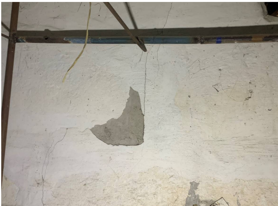
Рисунок 2.8 Разрушение защитного штукатурного слоя стен и перегородок
