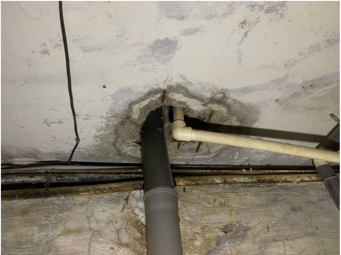
Рисунок 2.15 Неорганизованные отверстия в плитах перекрытия
