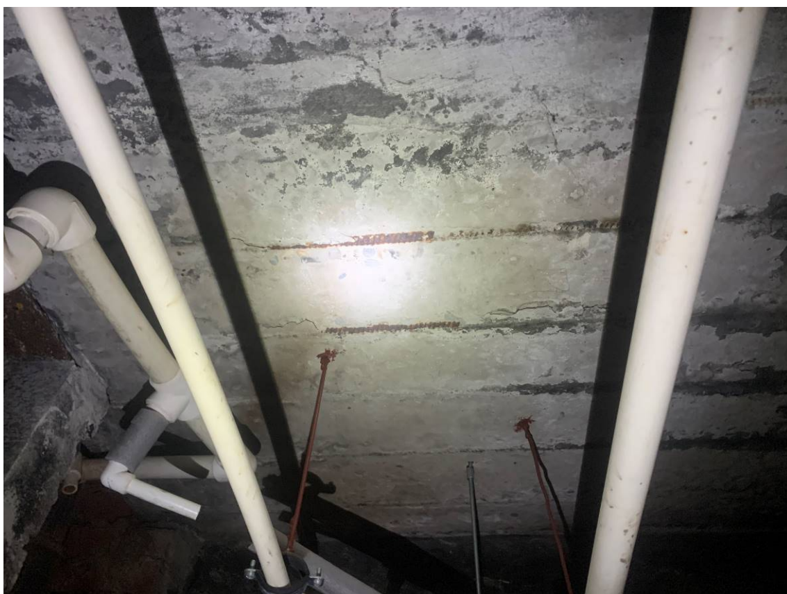
Рисунок 2.14 Разрушение защитного слоя бетона с оголением и коррозией арматуры в плитах перекрытия
