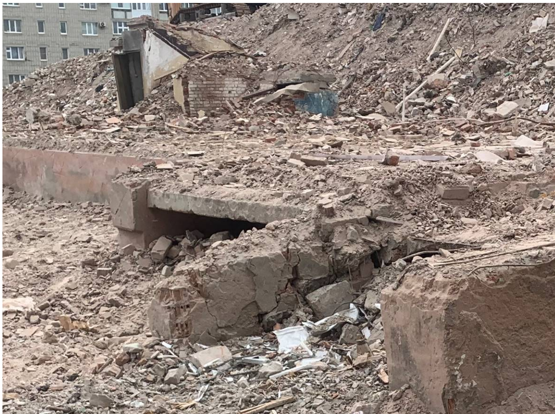
Рисунок 2.11 Разрушение кирпичной кладки пилонов
