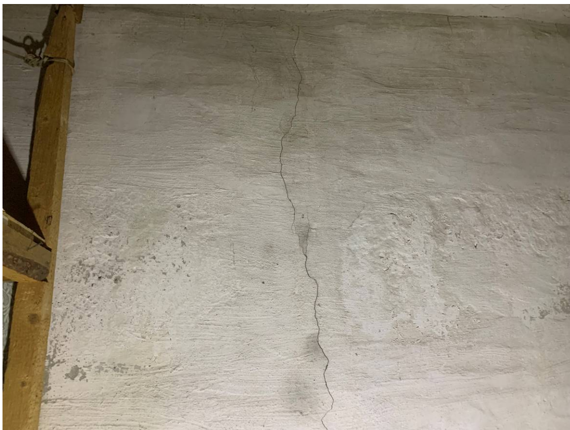
Рисунок 2.4 Трещины в стенах подвала
