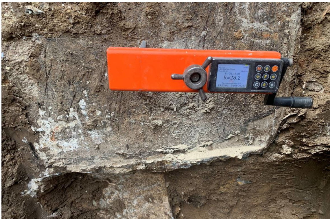
Рисунок 3.9 Определение прочности бетона ж.б. ростверка методом отрыва со скалыванием с помощью прибора ОНИКС-1.ОС.050
