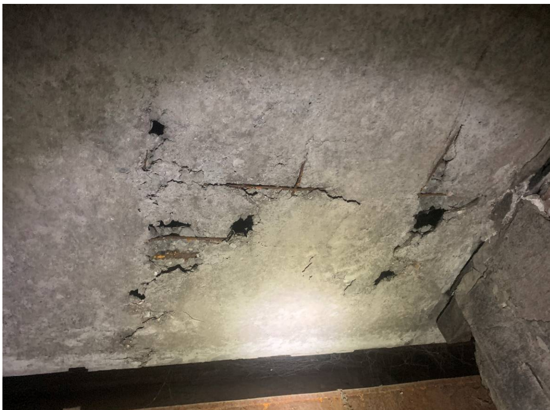
Рисунок 2.13 Разрушение защитного слоя бетона с оголением и коррозией арматуры в плитах перекрытия
