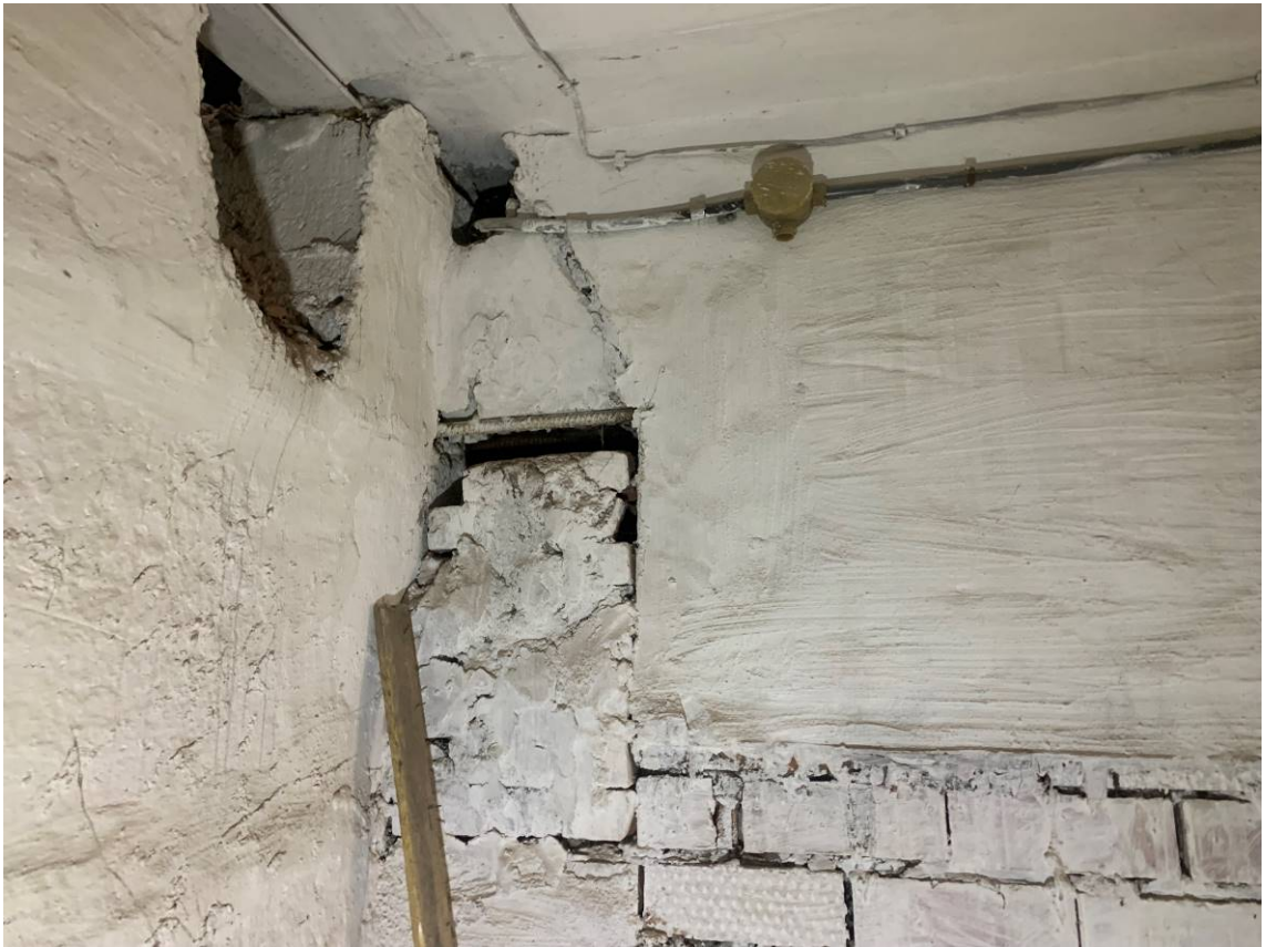
Рисунок 2.5 Неорганизованные отверстия в стенах подвала
