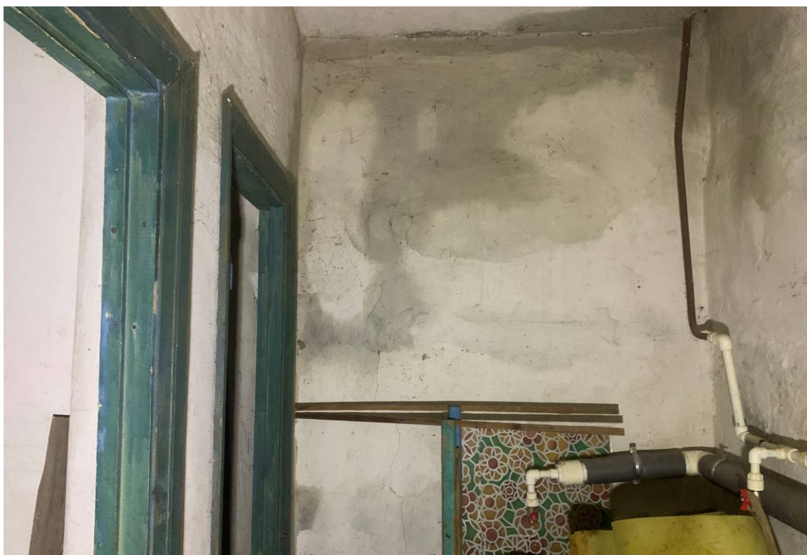
Рисунок 2.10 Следы замачивания стен и перегородок
