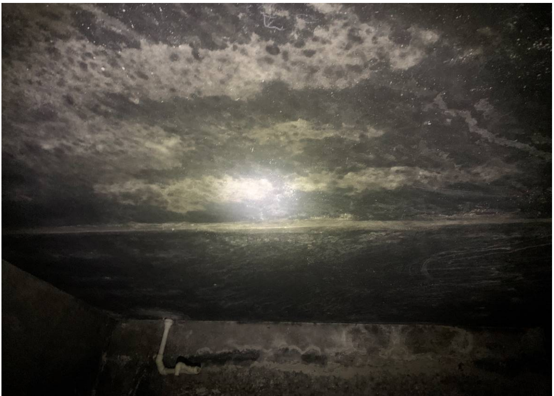
Рисунок 2.16 Отложение продуктов горения на плитах перекрытия
