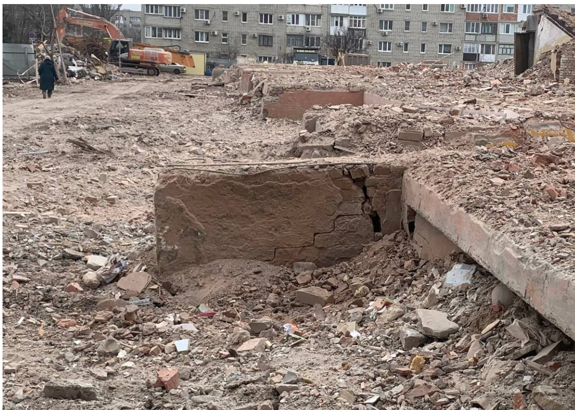
Рисунок 2.12 Сквозные трещины в кирпичной кладке пилонов
