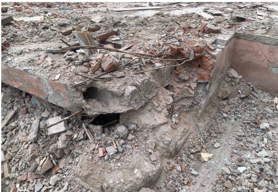
Рисунок 2.17 Разрушение плит перекрытия
