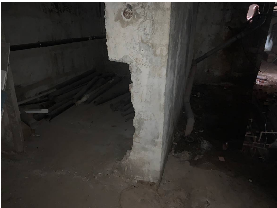
Рисунок 2.7 Разрушение кирпичной кладки перегородок
